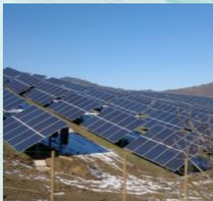
Impianto fotovoltaico ground-mounted
